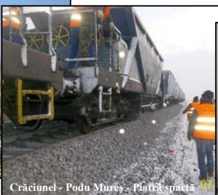
Crăciunel - Podu Mureș - Platră spartă
