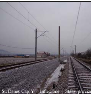
St. Danes Cap Y - Inflexiune - Stâlp provizoriu SCB
